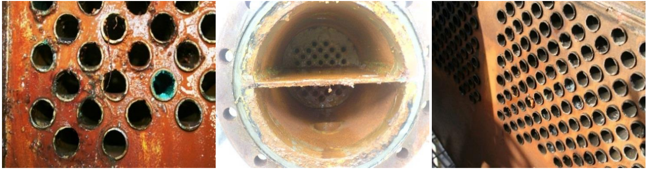
الف - لوله برنجی خورده شده مدل LE554B ب - خوردگی صفحات فولاد کربنی مدل LE554A ج - تخریب انتهایی لوله و حفرات متعدد خوردگی موضعی شکل ۲ - تصاویر واقعی از نواحی خوردگی در مبدل‌های حرارتی پوسته و لوله واحد LPG
