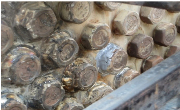
شکل ۷ - تصویری از خوردگی تنشی ترمیم شده در اطراف پلاگهای کندانسور هوایی.
