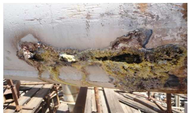
شکل ۳ - سوراخ شدن لوله در اثر خوردگی حفره‌ای.
