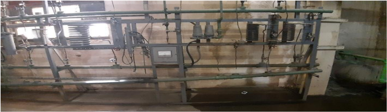
شکل ۵- تصویر ایستگاه نمونه‌گیری در نیروگاه بخار شهید منتظر قائم.
